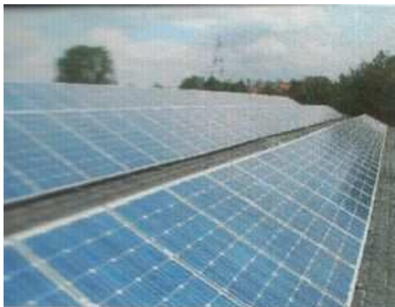
Die Fotovoltaikanlage der Solargemeinschaft auf dem Elsendorfer Schuldach Foto: Poet
